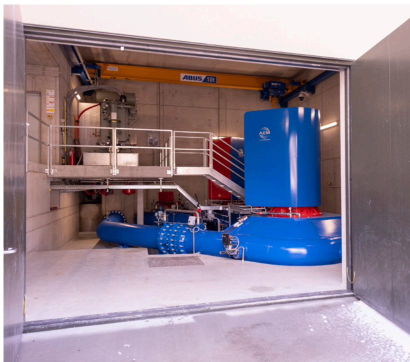
Blick auf das Herzstück des neuen Kleinwasserkraftwerks am Zürsbach: Zwei Pelton-turbinen mit einer Nennleistung von jeweils 1.000 Kilowatt.
