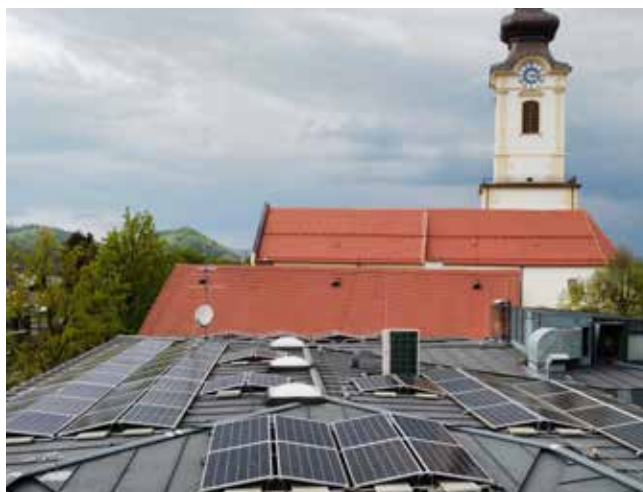
Die Photovoltaikanlage auf dem Dach der Raiffeisenbank Leibnitz deckt ein Viertel des Stromverbrauchs im Haus ab.
